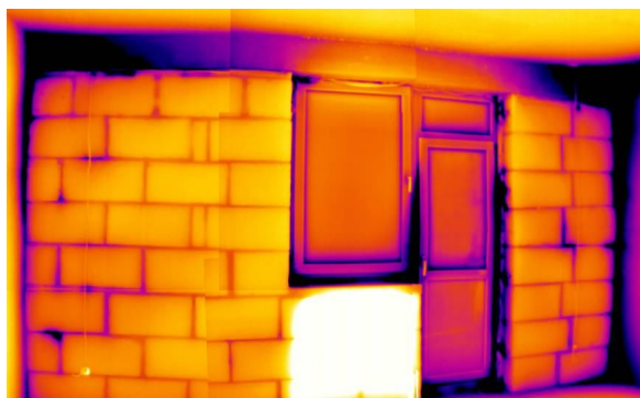
Рис. 1. Локальное нарушение технологии монтажа и конструкций и укладки утеплителя стен
