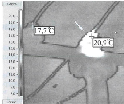
Рис. 2. Шинный мост 10 кВ на штырьковых изоляторах. Температура изоляторов: дефектного – 20,9 °С; исправного – 17,7 °С
