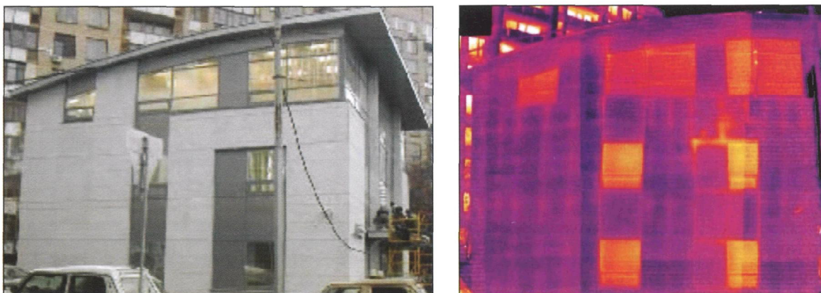
Рис. 6. Некачественное выполнение облицовки навесного фасада с вентилируемым зазором. Не выдержано расстояние между керамическими плитками, вследствие этого нарушен тепло-влажностный режим работы фасада и понижено качество конструкции
