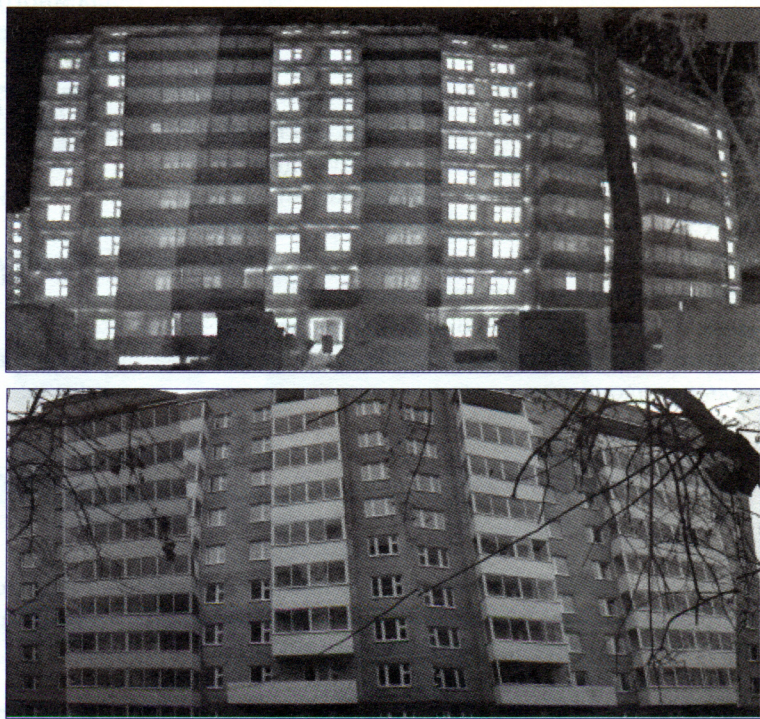
Рис. 1. Термограмма и фотография наружной стены здания
